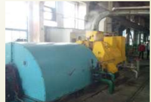
Парова турбіна та електрогенератор, ТЕЦ, м. Сміла
