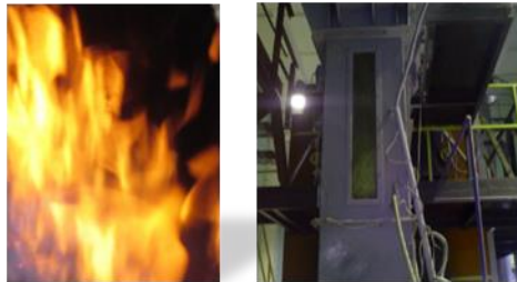
Подача і спалювання у котлі
