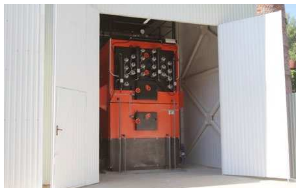
Рис. 4.6. Котельня з котлом КВМ-2,5 ТОВ Крігер Енергія.
