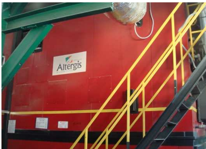
Рис. 4.9. Котельня на біомасі КПТМ «Черкаситеплокомуненерго».
