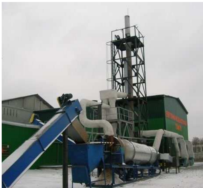
Рис. 4.8. Котельня на біомасі ДМП «Івано-Франківськтеплокомуненерго».
