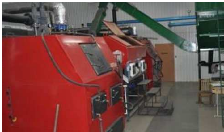
Рис. 4.11. Котельня на біомасі КП «Міськтепловоденергія» (м. Кам'янець-Подільський).
