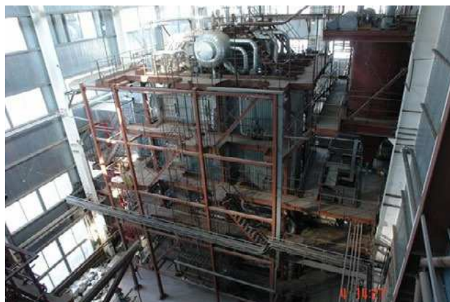
Рис. 4.5. Котел Е-16-3,9-360-Д на ТЕЦ «Кіровоградолія».
