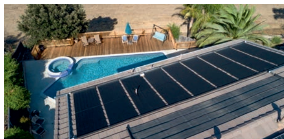
Рис. 4.17. Незасклений сонячний колектор для підігріву води
