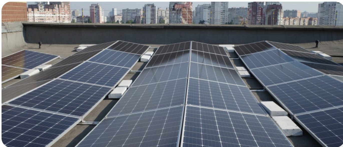
СЕС потужністю 300 кВт у на даху будинку у м. Київ (пр. Шухевича, 30)
