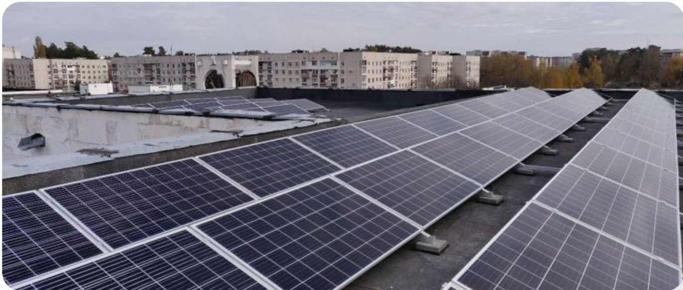
Дах універмагу «Мінськ», де енергокооператив «Сонячне Місто» встановив 144 сонячні панелі
