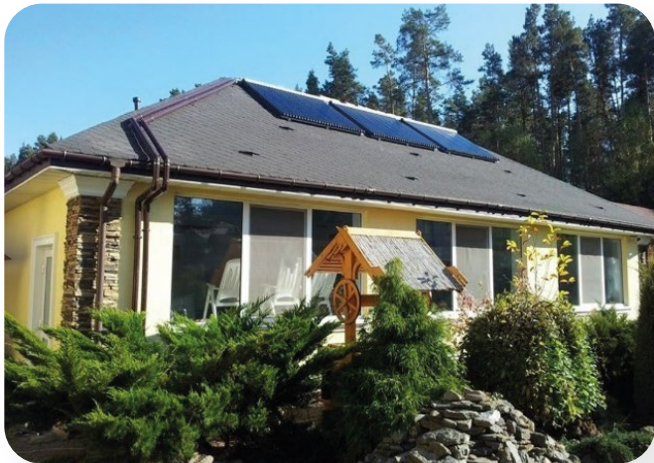
Сонячний або геліо колектор на даху будівлі 21
